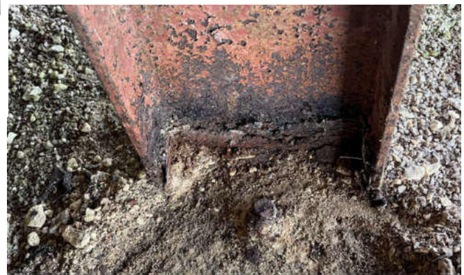
Détail 01 point de rouille pieds de poteau droite Nef 02
